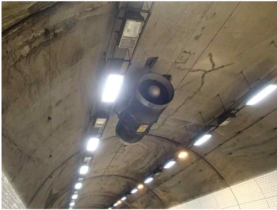
Jet Pan 설치 전경
